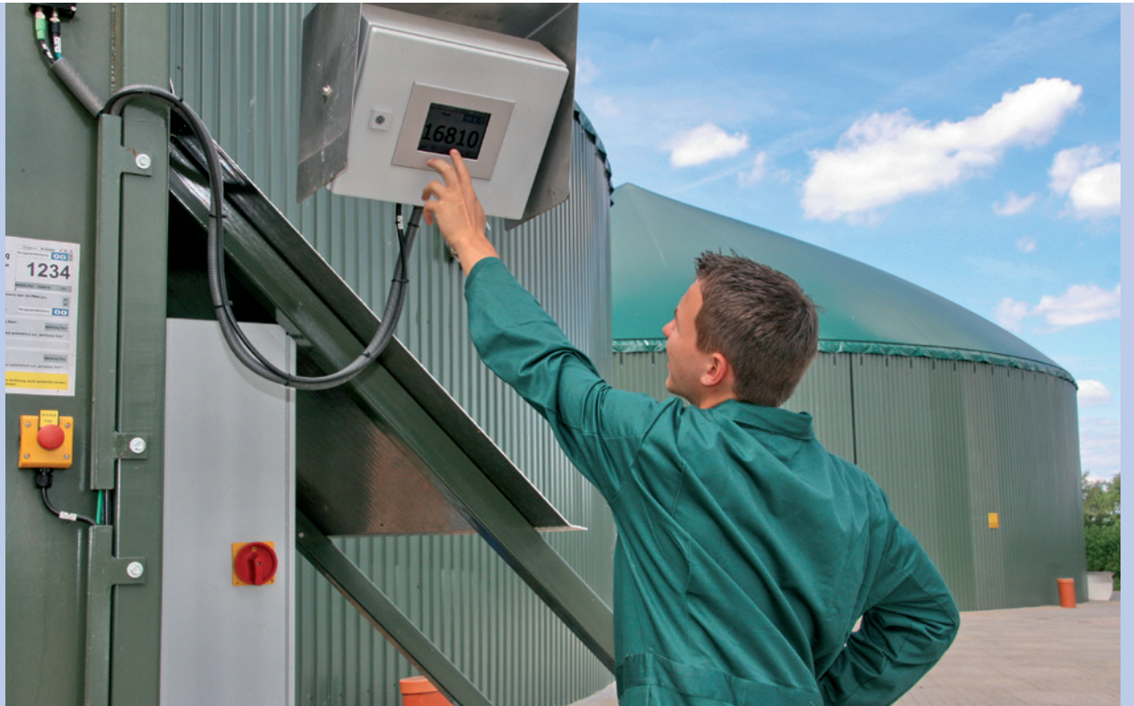
Biogas: Anspruchsvolle Elektronik sorgt für eine optimale Prozesssteuerung und einen stabilen Produktionsprozess.
